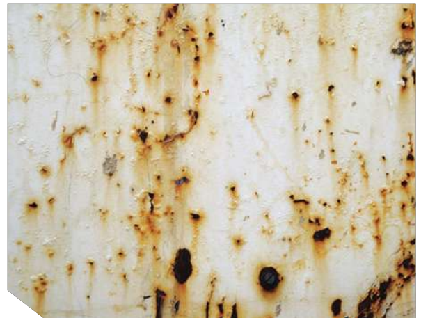
Fig. 3. Corrosión por contacto
