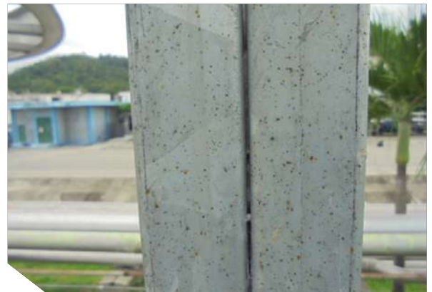
Fig. 2. Corrosión por picadura
